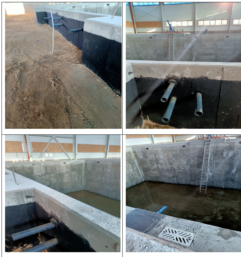
Dokumentacja fotograficzna wykonana w dniu 23 lutego 2022 r. przez Zespół Kontrolerów
